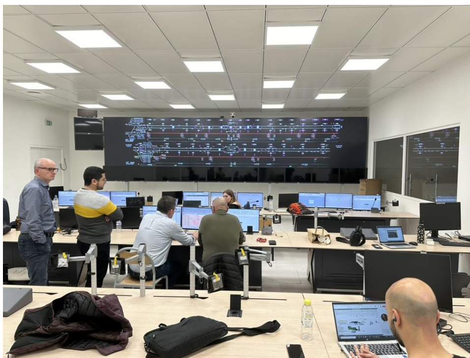
Figure 5 : Nouvelle salle de supervision du métro
