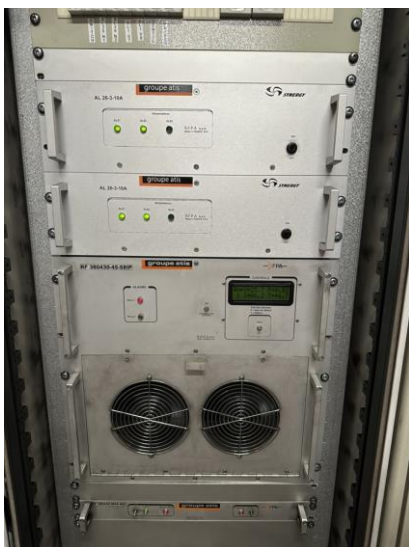
Figure 9 : Équipement radio en panne
